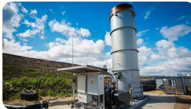
Высокотемпературное факельное устройство
